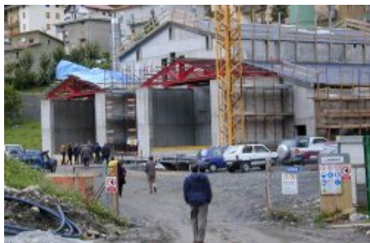
momento della visita alla centrale di Sondalo
